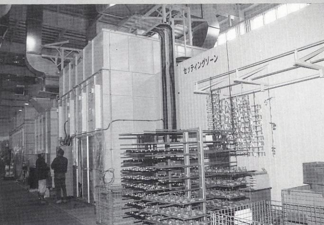
整然と並ぶ塗装ブース 左奥から第1～4ブース
