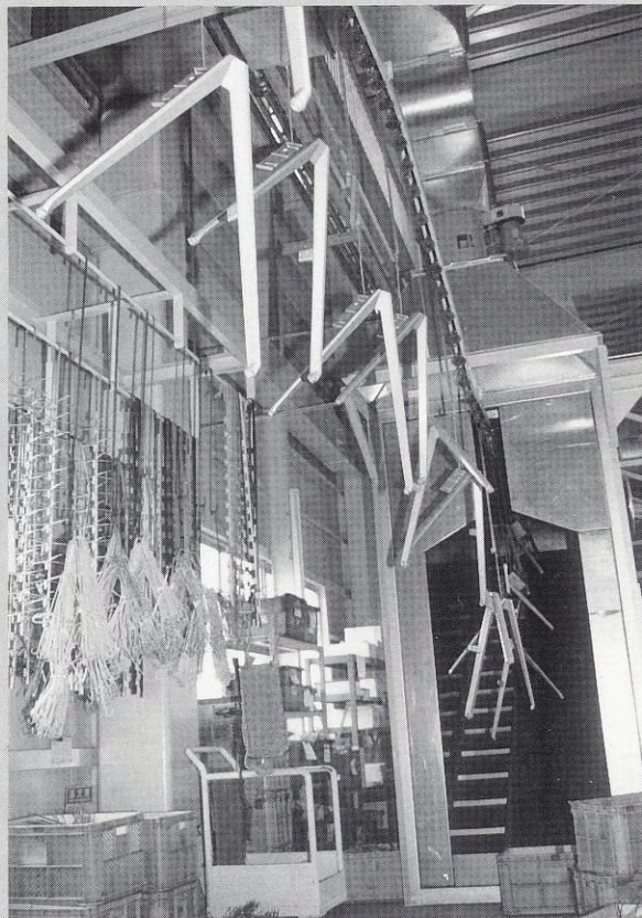
焼き付け乾燥炉の出口周辺
